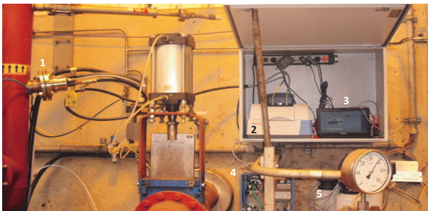
Abbildung 1: Aufbau des Inline-Messsystems auf der VKL. 1: Ceramat® WA 150 mit integrierter Diamant-ATR-Sonde in der Re-zirkulat-Leitung. 2: iS5-Spektrometer mit iD1-Modul als faseroptische Instrumentenschnittstelle. 3: Computer zur Steuerung des Messsystems. 4: Unical® 9000 Steuereinheit. 5: Behälter für diverse Flüssigkeiten mit integrierten Pumpen.
